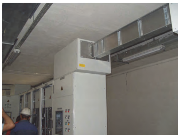
Рисунок 6 - Присоединение горизонтальное к шкафам РУНН не типовыми присоединительными секциями. ОЭМК, г. Старый Оскол
