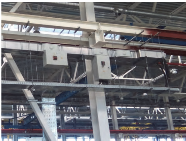
Коробка ответвительная вертикальная и горизонтальная с автоматическим выключателем и выносной рукояткой на двери.
