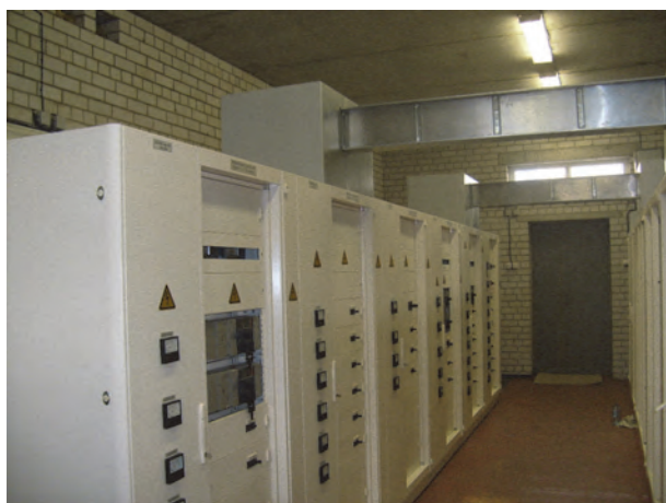
Рисунок 5 - Присоединение горизонтальное к шкафам РУНН не типовыми присоединительными секциями. Аэробус, г. Воронеж
