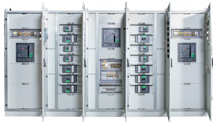
ГРЩ «Оскол» одностороннего обслуживания 1600А Объект ООО «Энергострой» г. Санкт-Петербург
