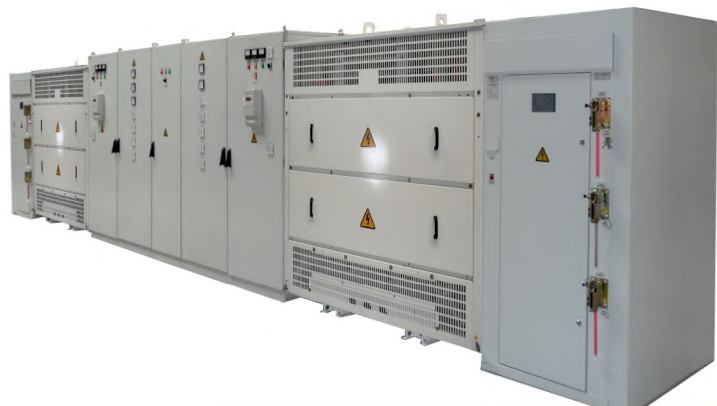
ГРЩ «Оскол» одностороннего обслуживания 2000А в составе 2КТПВ -Оскол-1000/6/0,4 УЗ Объект: ООО «Металл-Групп» Яковлевский рудник.
