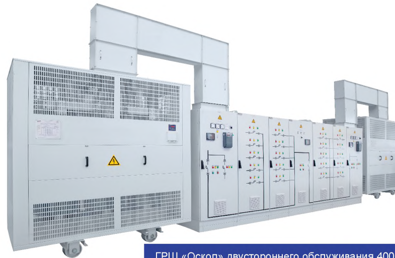
ГРЩ «Оскол» двустороннего обслуживания 4000А в составе 2КТПВ-Оскол-2500/6/0,4 УЗ Объект: ОАО «СГОК» Обогажительная фабрика.
