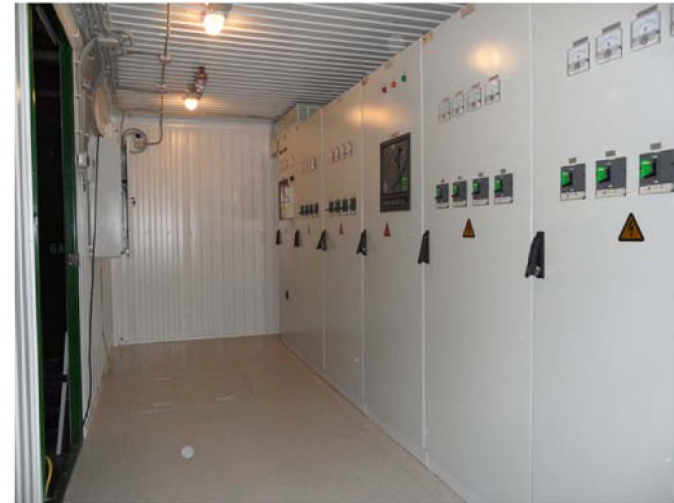
В металлических блок-модулях (наружная установка)
