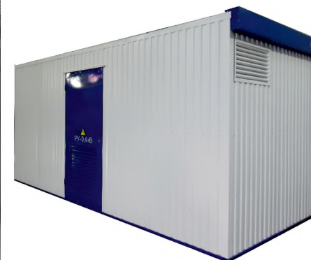
ГРЩ «Оскол» 1250А в блок-модуле Объект: АПК ДОН ЗАО «Алексеевский Бекон»
