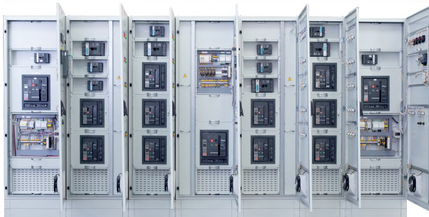
ГРЩ «Оскол» двустороннего обслуживания 4000А Объект: ОАО «Стойленский ГОК» г. Старый Оскол
